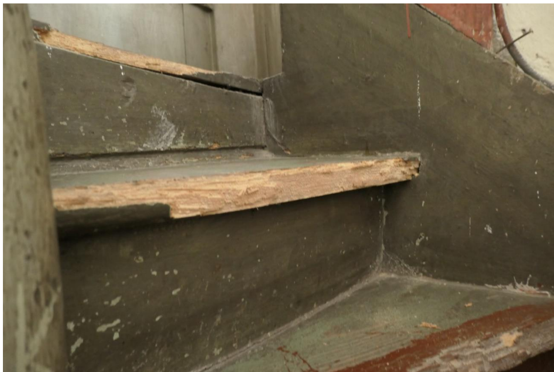
Ambona-schody – stan zachowania
