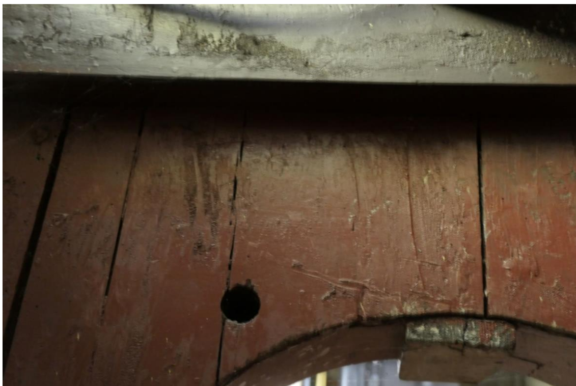
4. Bramka obejścia- stan zachowania.
