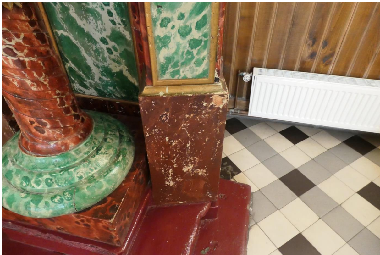
Bezstylowe przemalowania wykonane farbą ftalową
