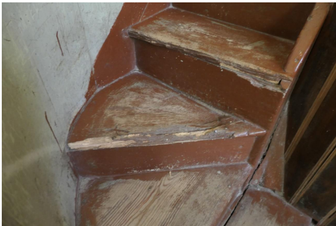
Ambona-schody – stan zachowania
